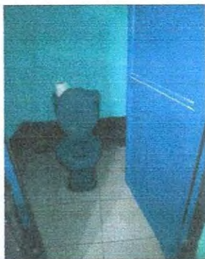
Servicios sanitarios y accesorios
